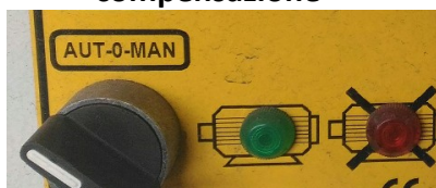
Quadro elettropompa di compensazione
